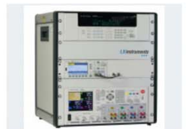
LXI-basierte Systeme verfügen typischerweise über Instrumente mit Frontpanel. (Bild: LX Instruments)
