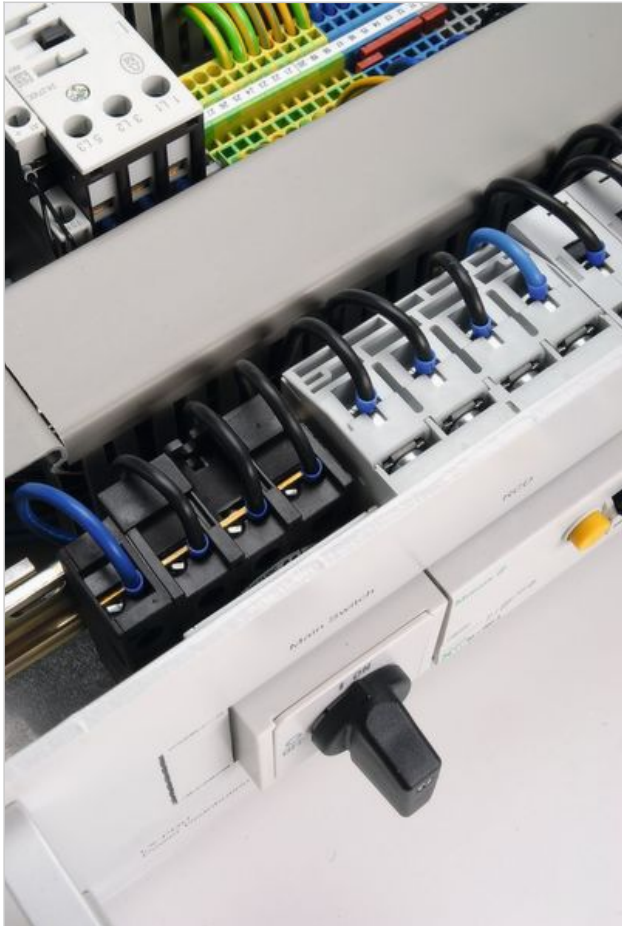
Innenansicht: Die Power Distribution Unit (PDU) ist aus Industriekomponenten aufgebaut. (LXinstruments)
